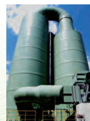
ブローアウト塔
