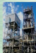
シアン製造プラント
