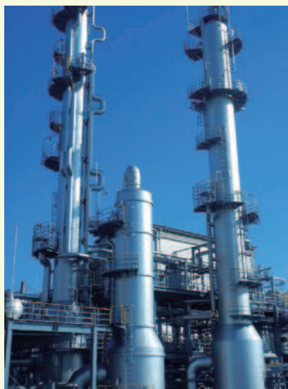
図1 CO 2 回収・原料化設備
