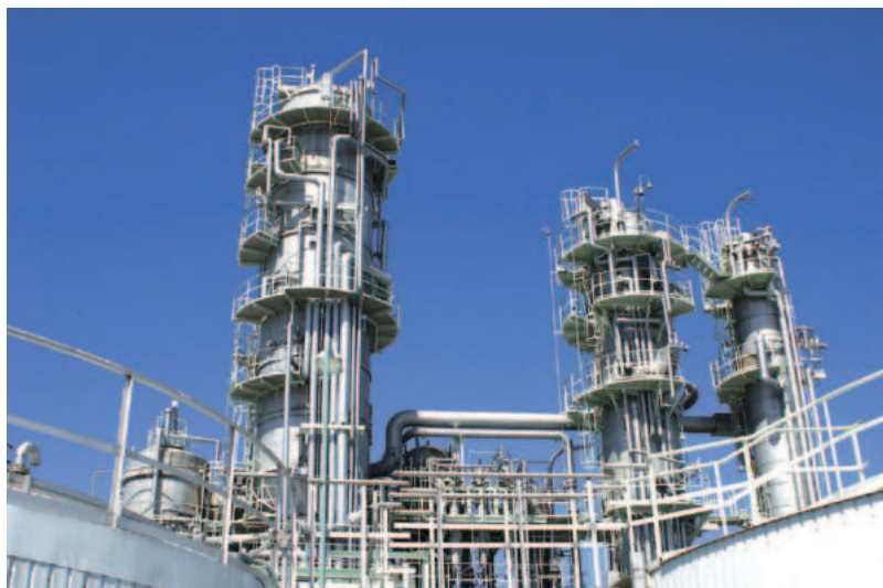
写真4 現在のトル油精留プラント（2代目）
