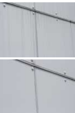
一般的な低汚染塗料で塗装した外壁 (上) と光触媒塗料 (ハイドロフェクトカラーコート) で塗装した外壁 (下) の汚れ比較。塗装2年5カ月時点で撮影 (提供：TOTO 株式会社)
