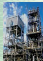
シアン製造プラント
