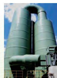
ブローアウト塔
