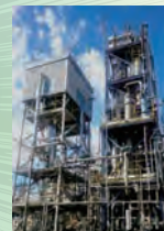
シアン製造プラント
