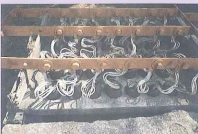
電解槽上部の陽極
