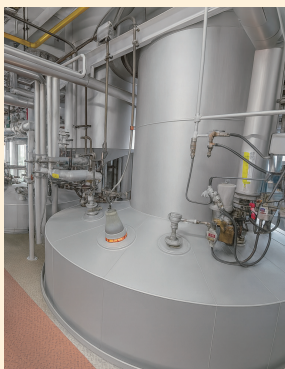
現在の真空蒸留缶 (大八化学工業株式会社 福井工場)
